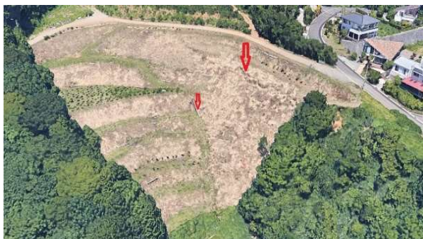
写真5 Google(写真3)における当該盛土の 拡大図 (矢印は亀裂やコンクリート 片など)
